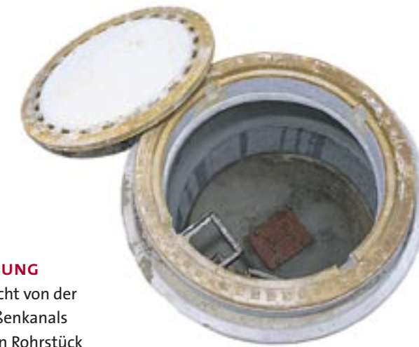
Übergabeschacht des Hauskastens außerhalb des Gebäudes
